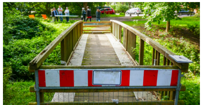
Gesperrt – und dann vergessen · Fotos: fb
