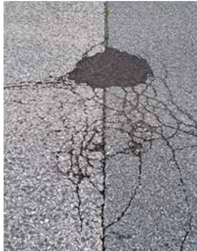
Schlagloch, provisorisch geflickt
