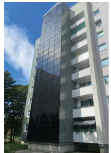
Die größte Solaranlage des Osdorfer Born an der Südseite der Bornheide 79.
